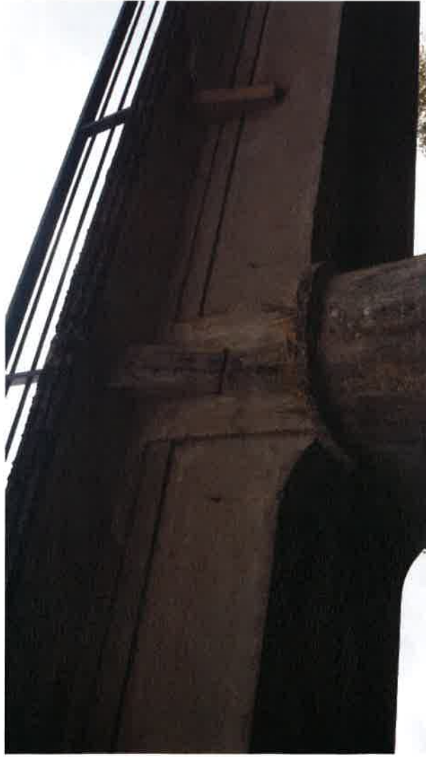
17 zatékání dilatační spárou nad pravým pilířem.JPG
