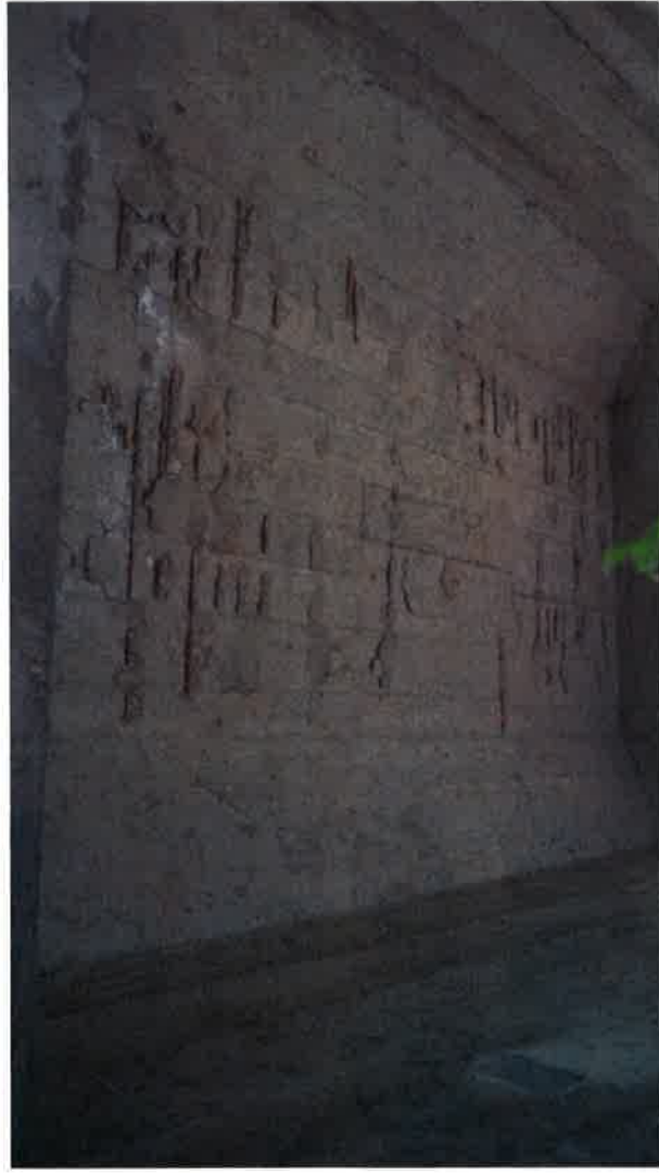
19 obnažená výztuž mostovky v pravém poli.JPG
