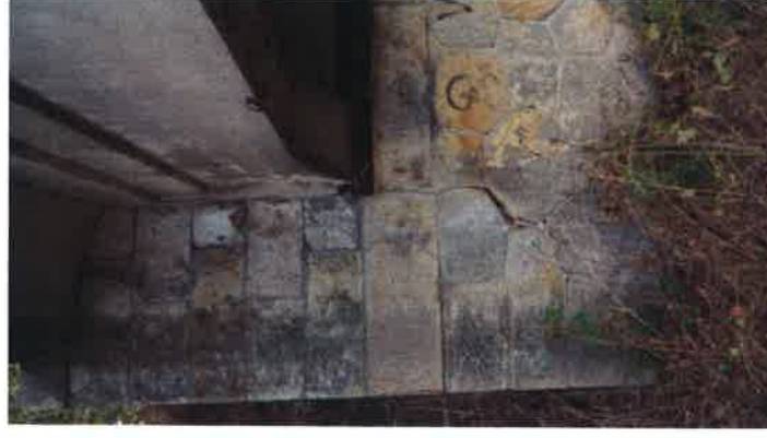
06 prasklina v pravobřežní opěře.JPG
